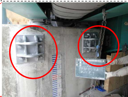
落橋防止装置(橋軸方向)
